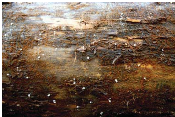
Slika 8: Poškodbe zaradi G. materiarius (Foto: François-Xavier Saintonge, Francija)
